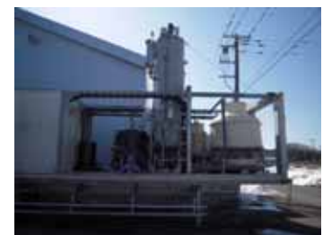
写真.4 雪氷による移動式シャーベット氷製造装置
