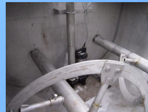
写真 4 . 5 スクリュー(ポンプ側)
