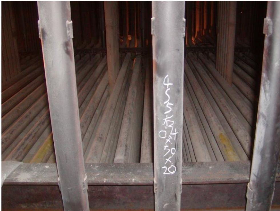
苫東厚真1号ボイラ1次過熱器上段
