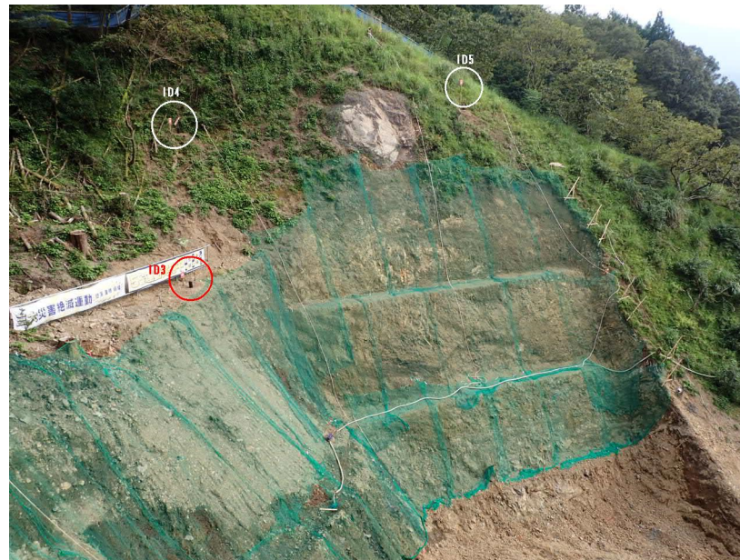
地すべりセンサの危険区域への設置
