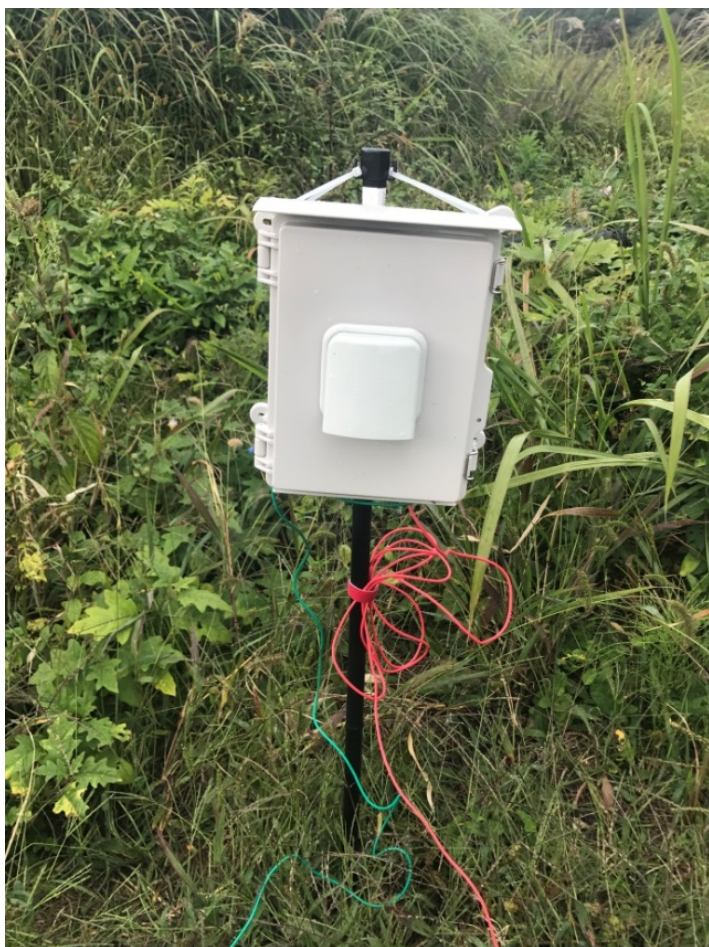
漏電通報装置
